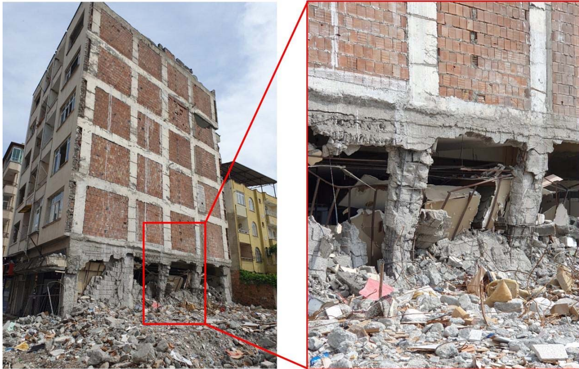
Fig. 6 Foto del danneggiamento dovuto allo sviluppo di un meccanico di piano soffice di un edificio in c.a.
