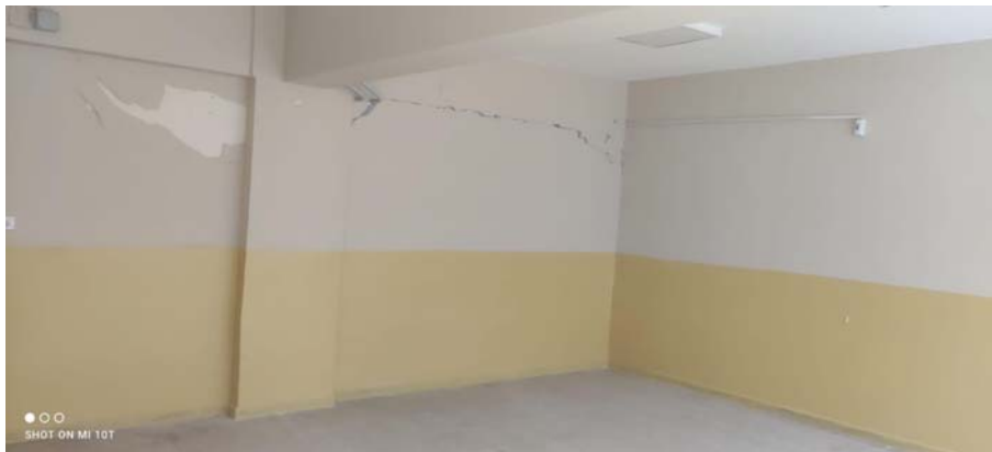
Fig. 4 Foto del danneggiamento rilevato nella zona di interfaccia tra il telaio originario in c.a. e il setto adottato come sistema di rinforzo
