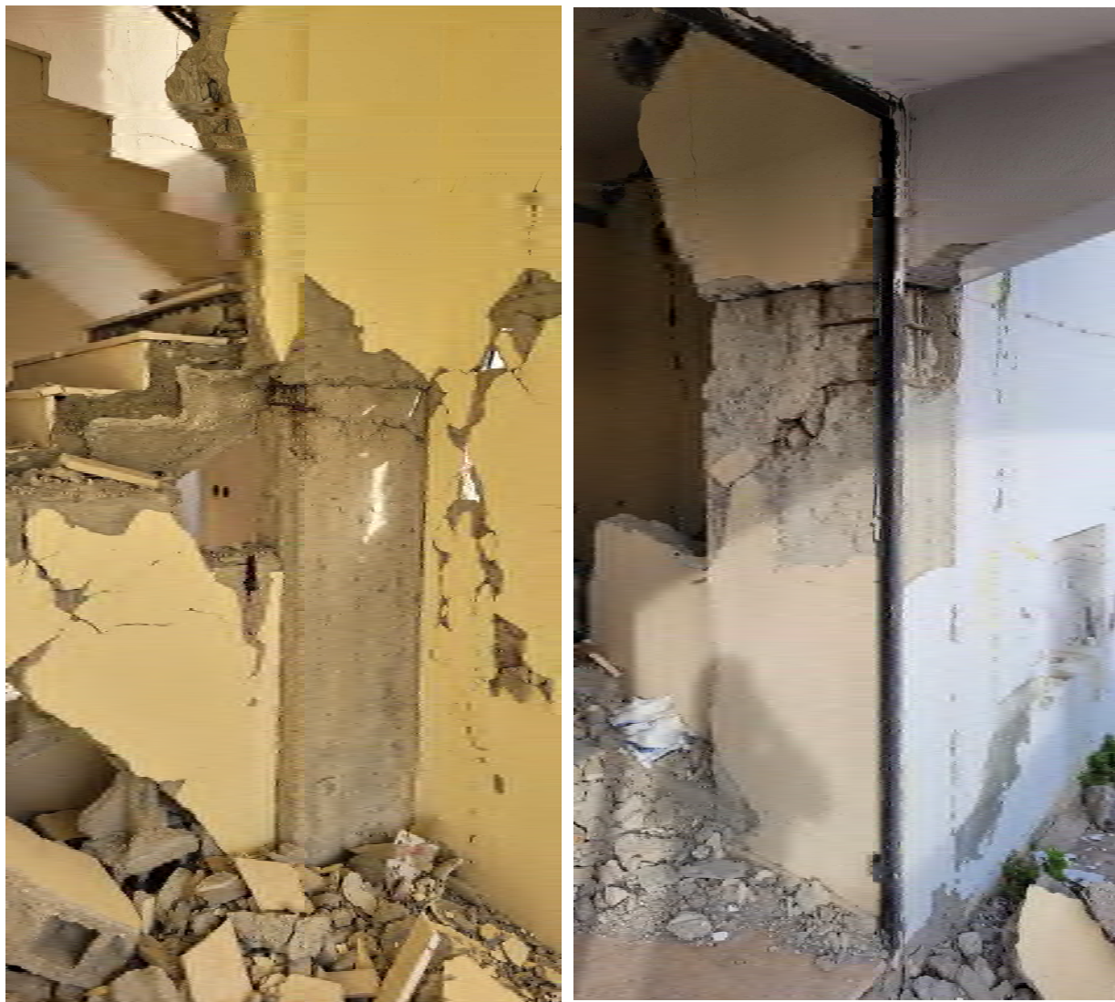
Fig. 15: Danno ai pilastri
