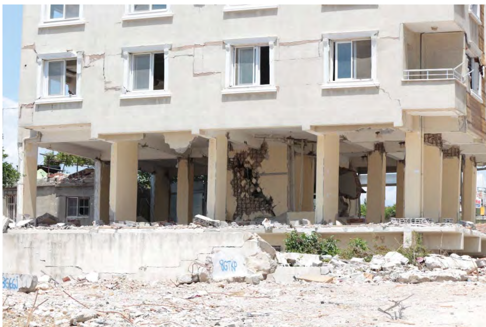
Fig. 16. Danneggiamento setto in c.a. a taglio e danno in testa ai pilastri al piano terra.
