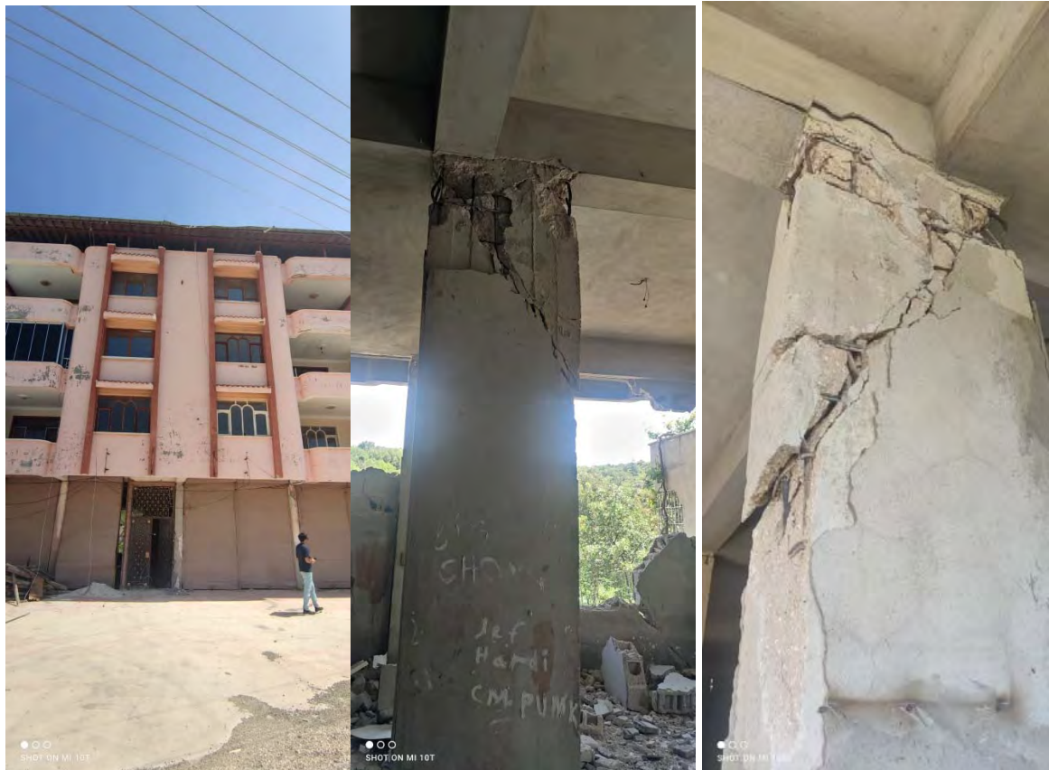
Fig. 19 Crisi a taglio in più pilastri in c.a. di edifici adiacenti alla cassa scala
