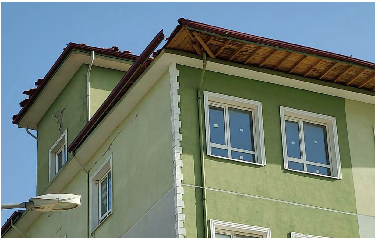
Fig. 7 – Collasso di parte della copertura.
