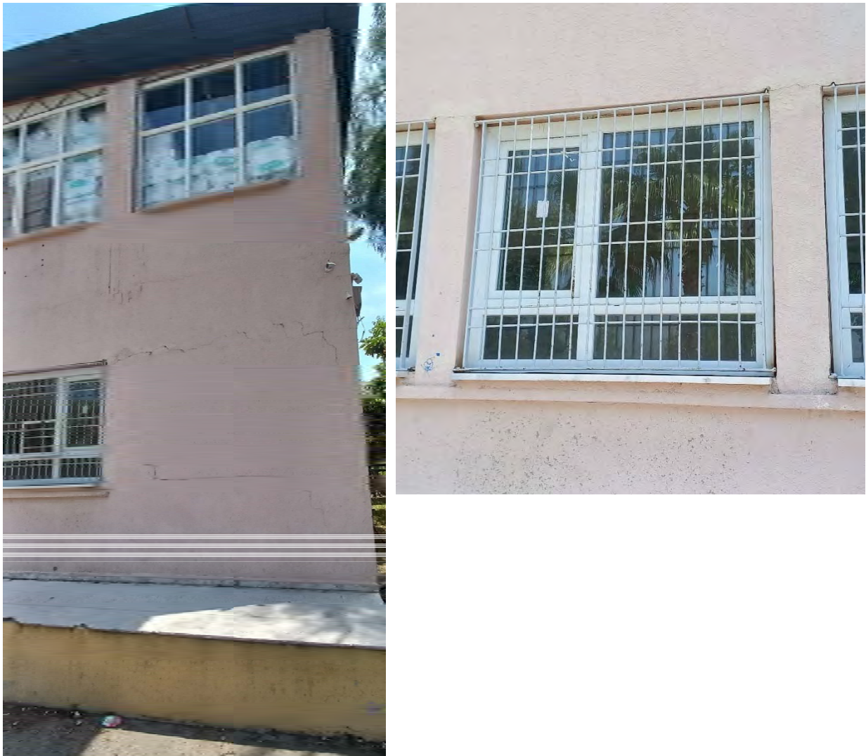
Fig. 13: Danni lievi all'interfaccia delle tamponature
