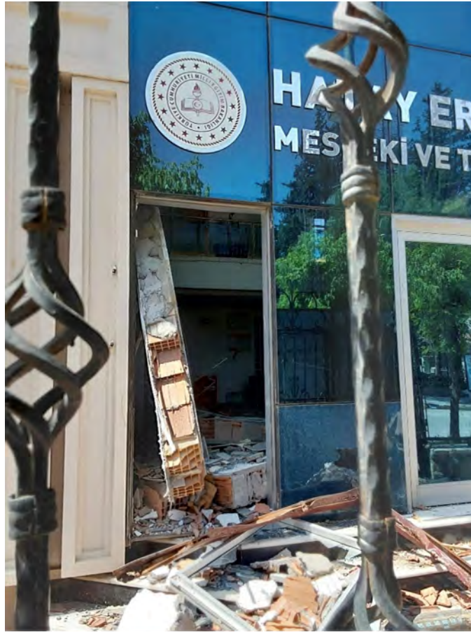
Fig. 12. Ribaltamento tramezzature all'interno dell'edificio
