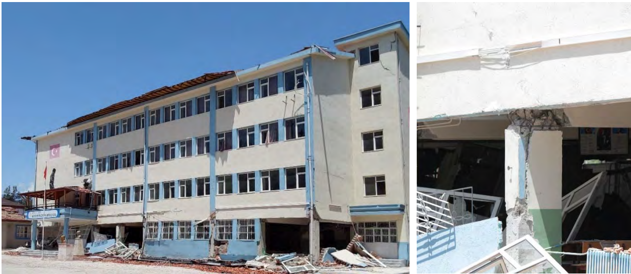
Fig. 9. Effetto di piano soffice connesso anche al ribaltamento parziale delle tamponature di facciata; plasticizzazione flessionale dei pilastri .
