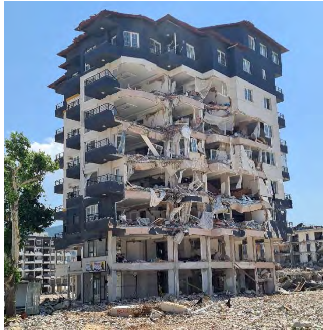
Fig. 18 Collasso delle tamponature esterne e danno alle travi perimetrali in un edificio a telaio con pilastri arretrati.
