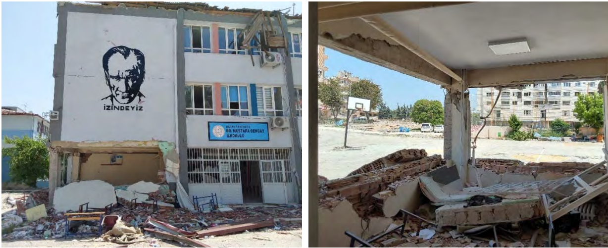
Fig. 8 Pannello di sinistra: vista frontale; pannello di destra: vista dall'interno, muri esterni ribaltati e plasticizzazione pilastri con disorganizzazione del nucleo del calcestruzzo per mancanza di adeguato confinamento passivo
