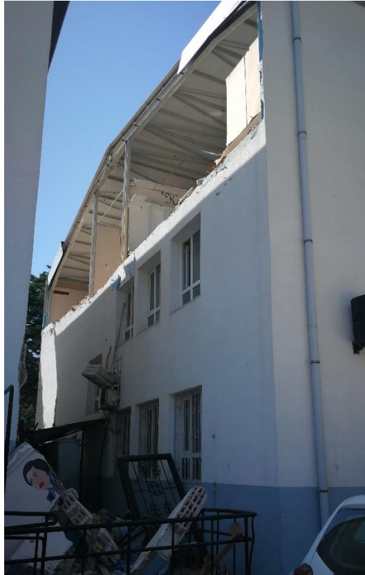
Fig. 3 Sopraelevazione in struttura metallica e copertura a travi reticolari, non adeguatamente collegata ai tamponamenti perimetrali
