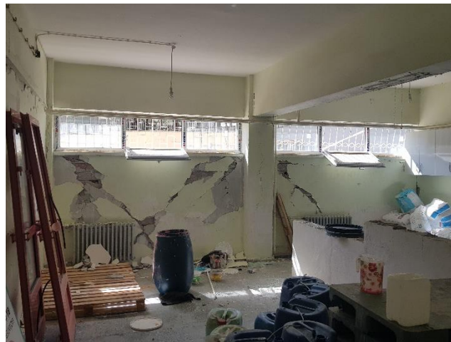
Fig. 7: Ampia fessurazione diagonale di tamponature e partizioni.
