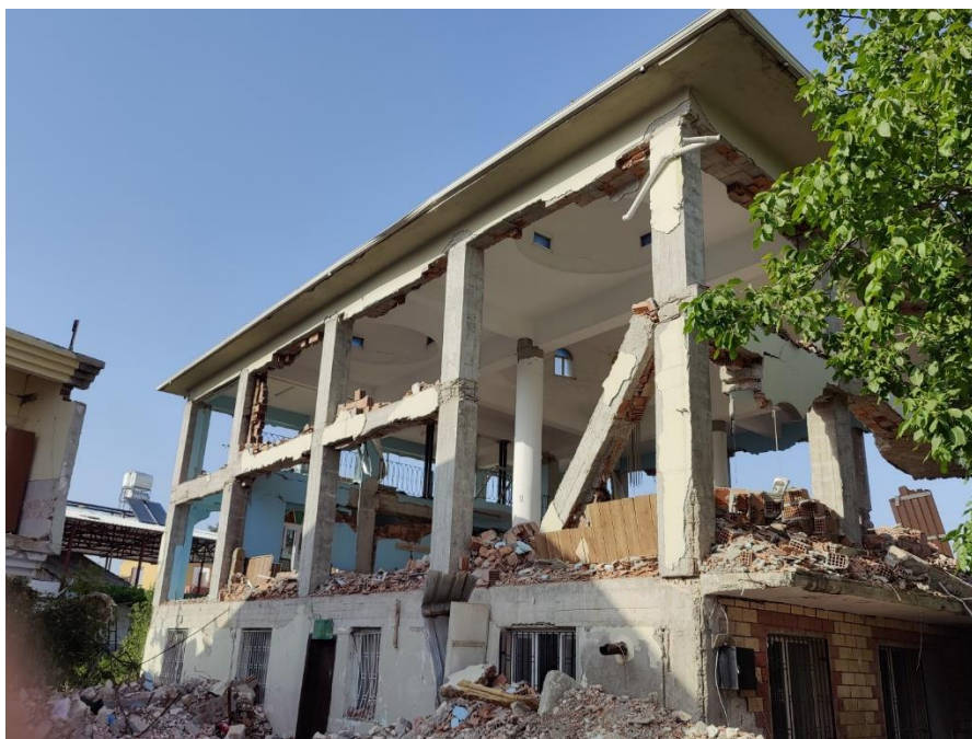
Fig. 8: collasso parziale di impalcato e trave in c.a.
