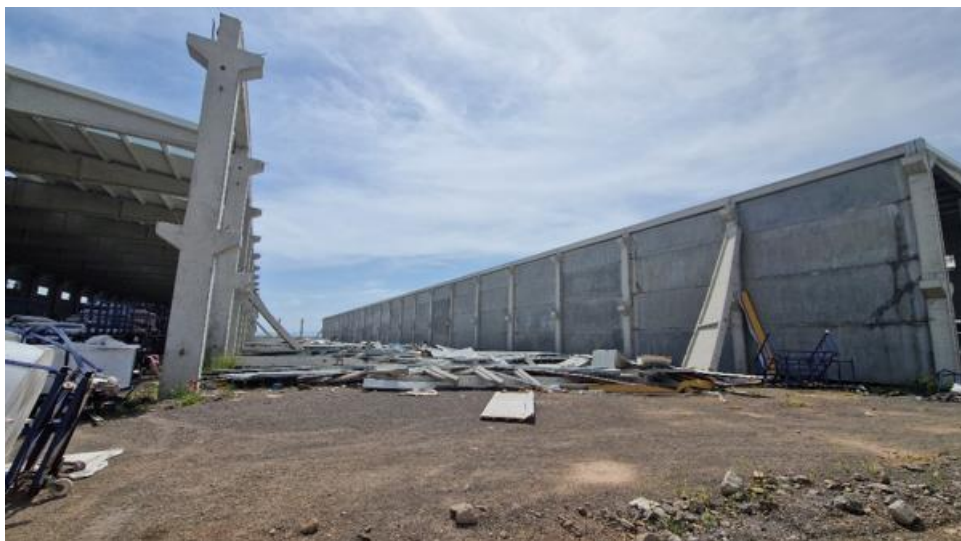
Fig. 14 – Particolare del crollo delle capriate.
