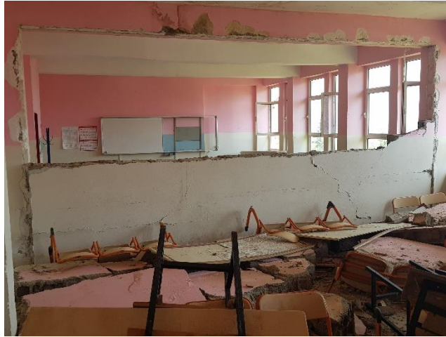
Fig. 8: ribaltamento fuori piano di tamponature e partizioni.
