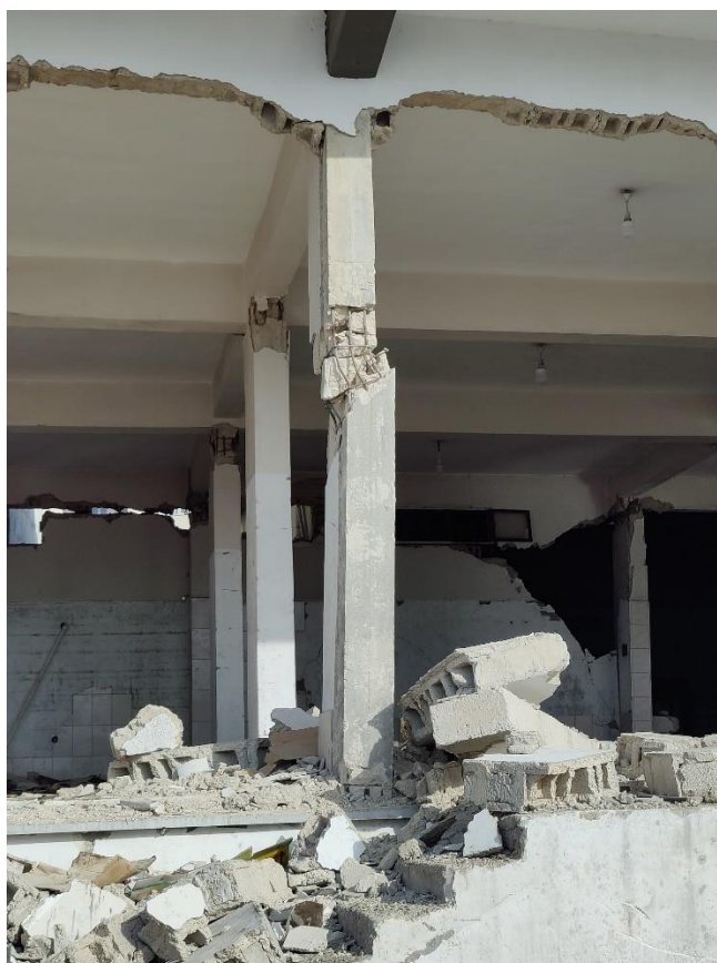
Fig. 9: crisi a taglio di un pilastro in c.a.
