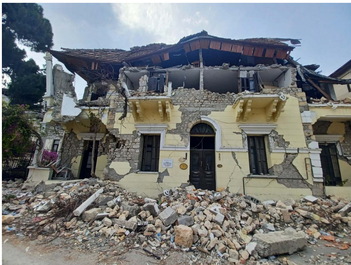
Fig. 9 - Stato di danno di edificio in muratura in pietra nel centro storico di Antiochia: collasso della copertura, meccanismi di crisi fuori piano e nel piano delle pareti. Peculiare è la sopravvivenza delle mensole dei balconi.
