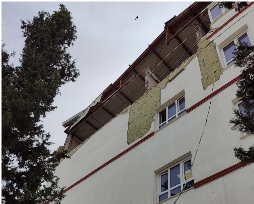
Fig. 5 – Vista frontale dell’edificio. e collasso fuori piano della tamponatura all’ultimo piano (edificio rinforzato con setti prima dell’evento sismico)
