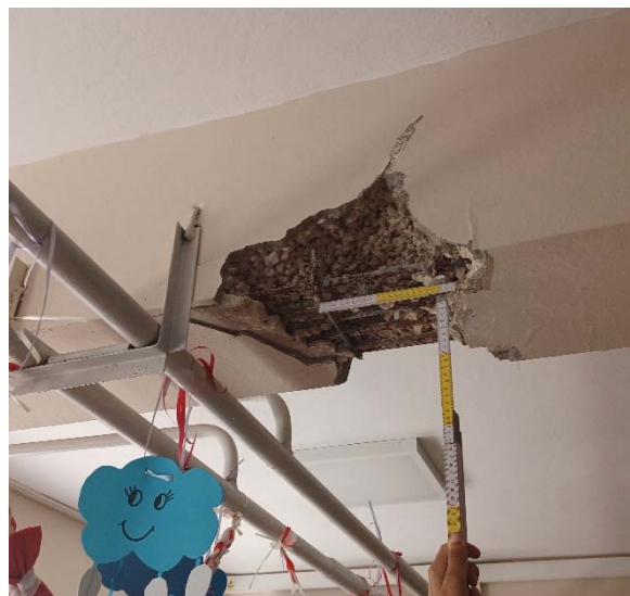
Fig. 3. Danno localizzato in trave al piano terra in corrispondenza di aggancio di impianti, principalmente dovuto alla scarsissima qualità del calcestruzzo (presenza di vespajo).
