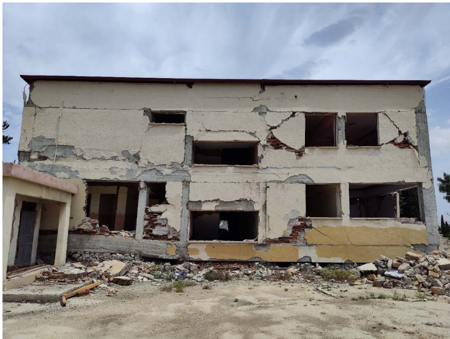
Fig. 4 – Vista prospettica dell'edificio e grave stato di danneggiamento diffuso (edificio non soggetto ad intervento di rinforzo prima dell'evento sismico)
